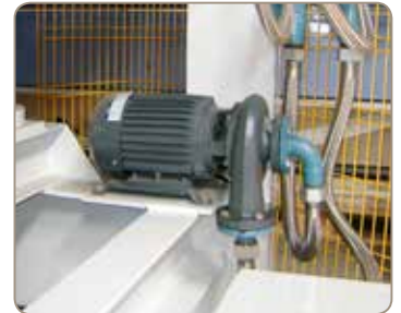
Ölförderpumpe für Thermoöl
